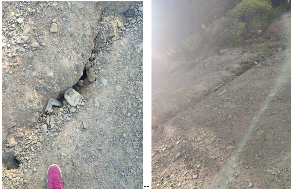
Figura 22. Falla geológica en talud Alpacoma
